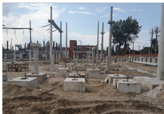
Ilustración 1 - Subestación Montevideo K
